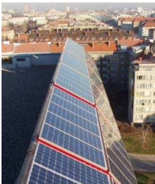
Fotovoltaická elektrárna na střeše budovy MŽPČR. Foto: MŽP
