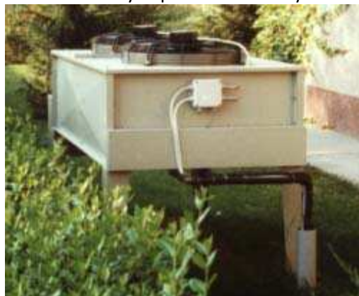
Venkovní jednotka tepelného čerpadla vzduch/voda. Foto: EkoWATT
